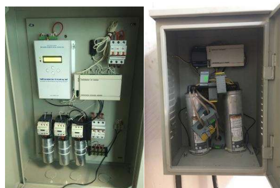
Hình 7: Thiết bị giám sát tủ bù hạ thế
